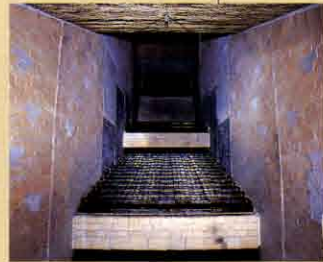
●焼却炉 炉内では、ごみ質の変化に応じて燃焼用空気を調節し、乾燥ストーカーで乾燥させた後、燃焼・後燃焼の各ストーカーで完全焼却します。
