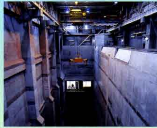
●ごみビット・ごみクレーン ごみビットに貯められたごみを、ごみクレーンでつかみ、ごみ投入ホッパへ投入します。
