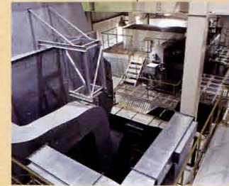
●電気集塵器 焼却炉から出る排ガスに含まれた微細なばいじんを取り除き、きれいなガスにします。
