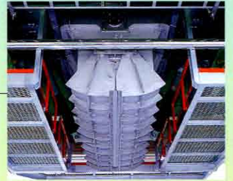
●処理物バンカ 混練機で処理された物を灰搬出車に積み込み、最終処分場へ運び出されます。
