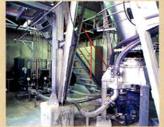
●有害ガス除去装置 ごみの焼却時に発生する有害ガスを除去する装置で、排ガスと薬品を反応させます。
