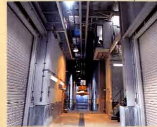
●灰ビット・灰クレーン 焼却後の灰は、灰ビットに貯留された後、灰クレーンで灰搬出車に積み込まれ、最終処分場へ運び出されます。
